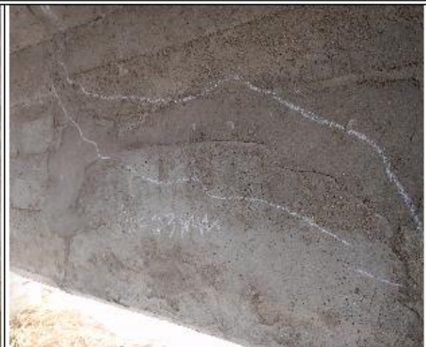
T-BEAM 현황(S1G3, 사인장균열)
